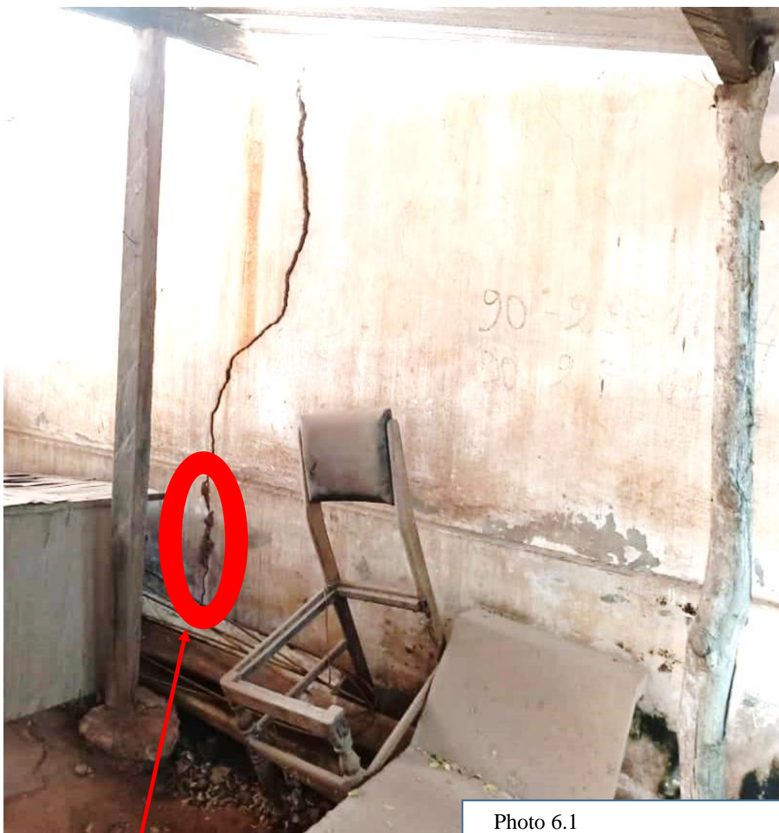
Fissure du soubassement
