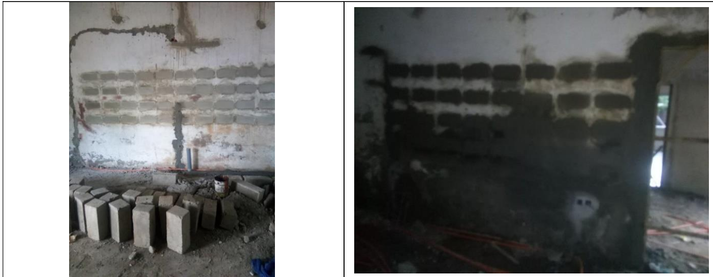
A : Evolution de la fermeture des fissures et costrats
