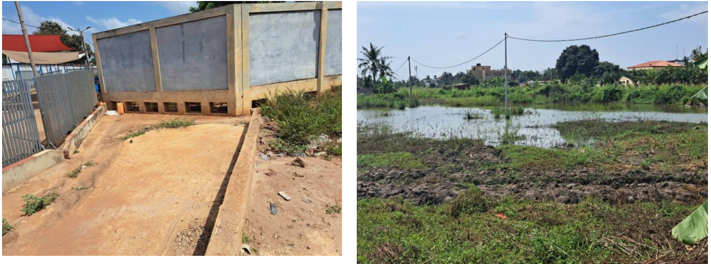
Photo 2: Évacuation et stagnation des eaux pluviales
